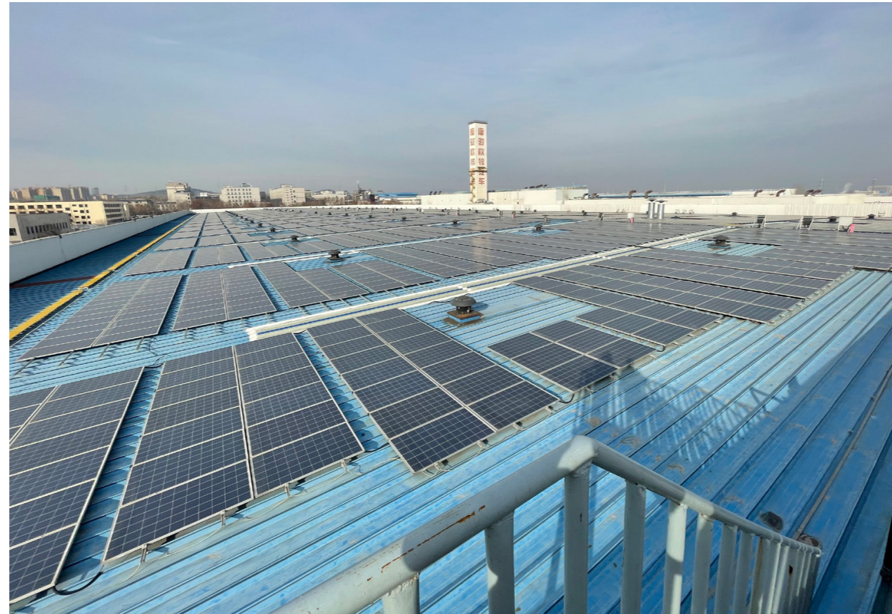
吉利商用车唐骏基地车间屋顶及停车场铺设的光伏板
